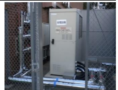
総合福祉センターの発電機
