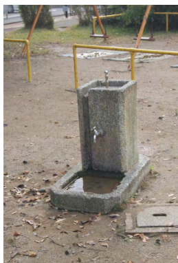
給水設備 (手洗い場・水飲み場)
