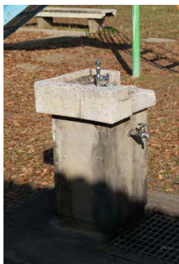
給水設備 (手洗い場・水飲み場)
