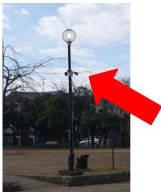
防犯・安全設備（防犯カメラ）
