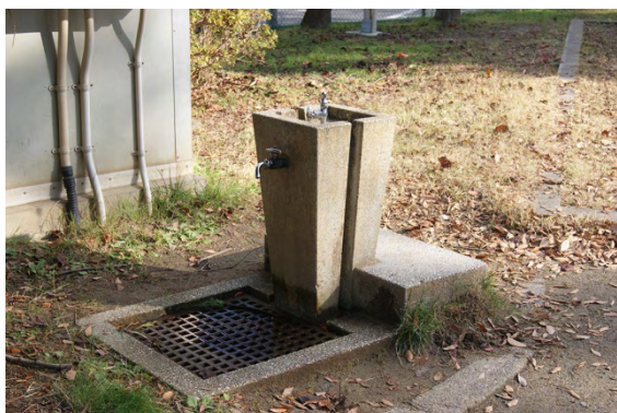
給水設備 (手洗い場・水飲み場)
